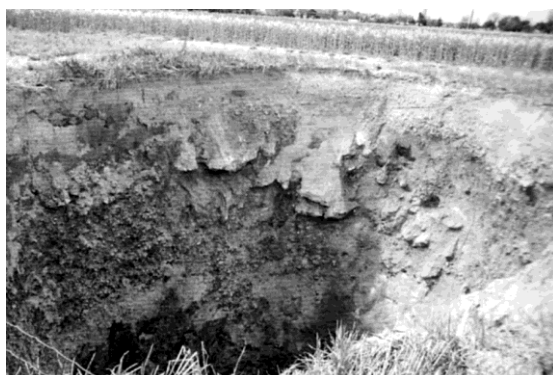
Photo 1. Effondrement à l'aplomb d'une carrière souterraine
