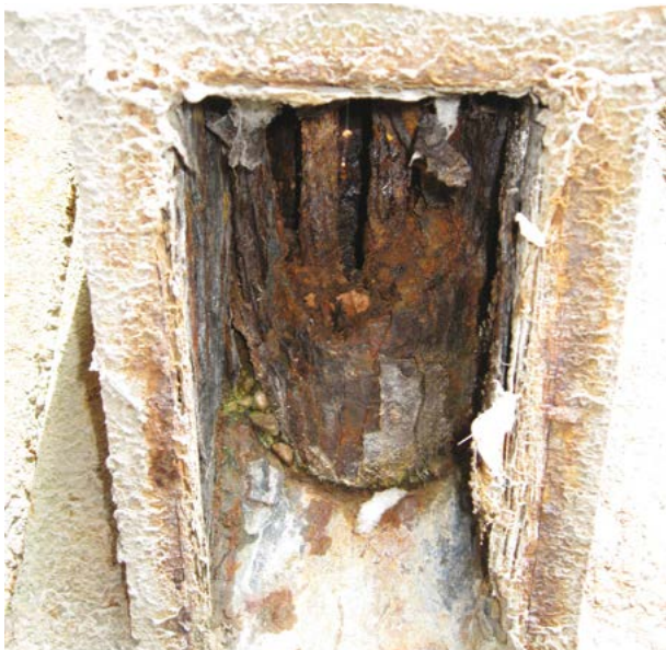
Photo 6.1 : illustration de l'effet d'un défaut de protection au niveau d'une tête d'ancrage (©SMG)
