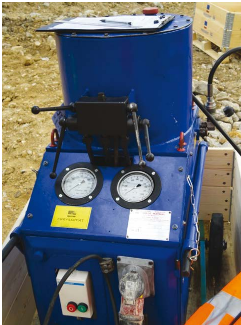
Photo I.3 : Pompe hydraulique d'alimentation du vérin de mise en tension (© Freyssinet)
