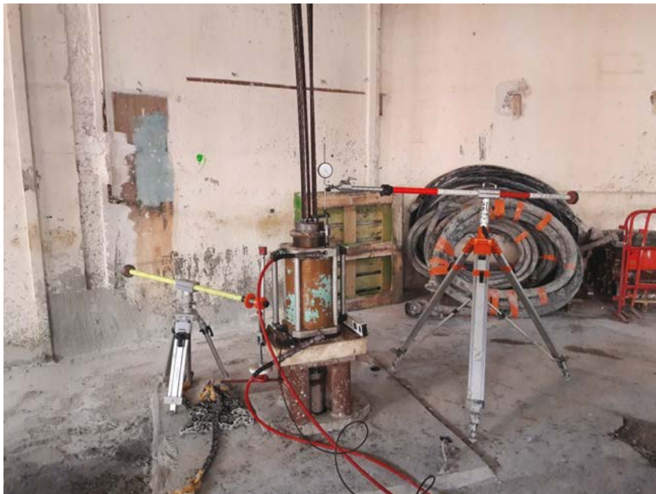
Photo I.5 : Dispositif de mesure des déplacements (© Spie Fondations)
