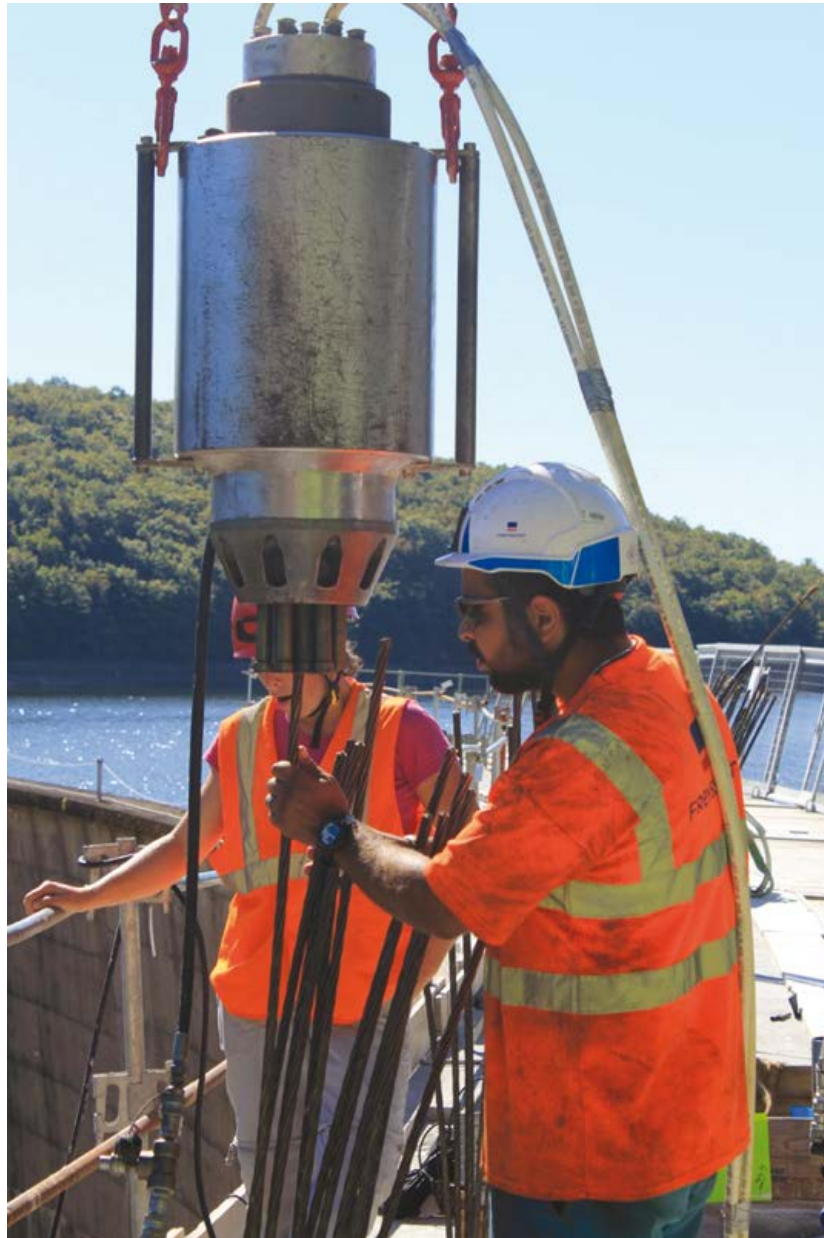
Photo 7.16 : Mise en place du vérin de mise en tension sur un tirant à câbles (© Freyssinet)
