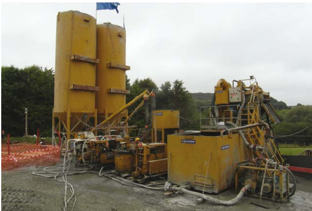
Photo 7.11 : centrale de fabrication de coulis (© Sefi Intrafor)
