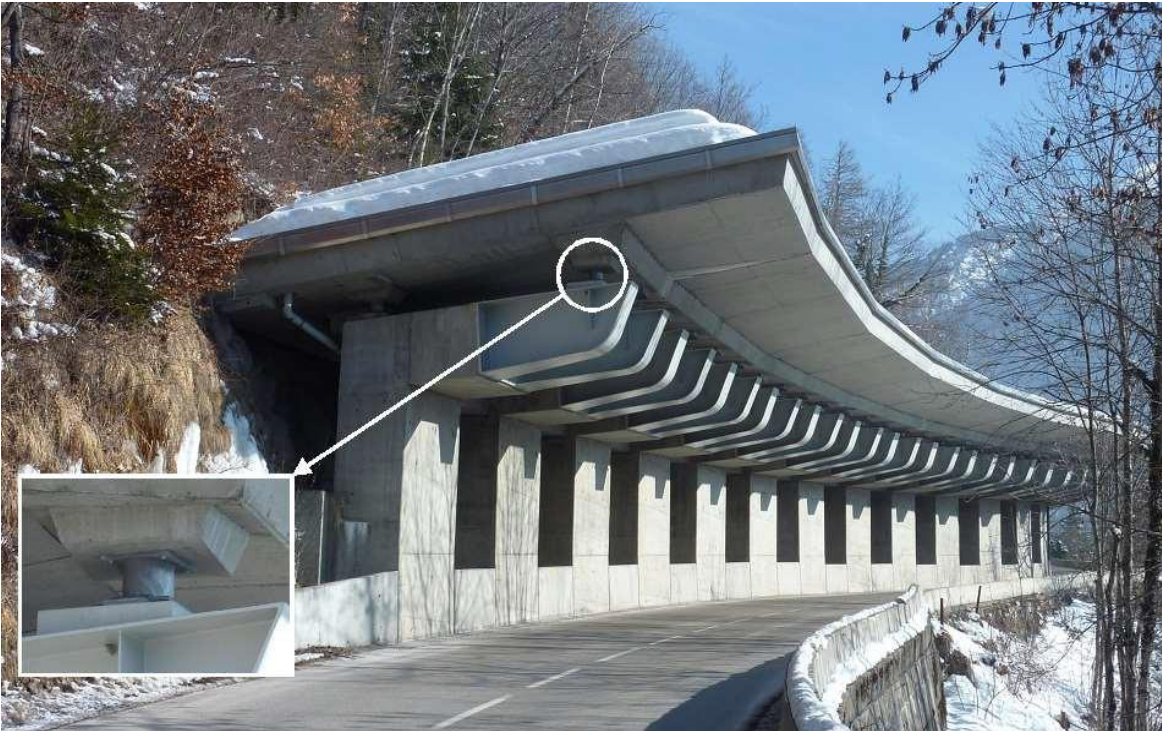
Galerie à dalle 'inversée', capacité 16 MJ. Champagny en Vanoise
