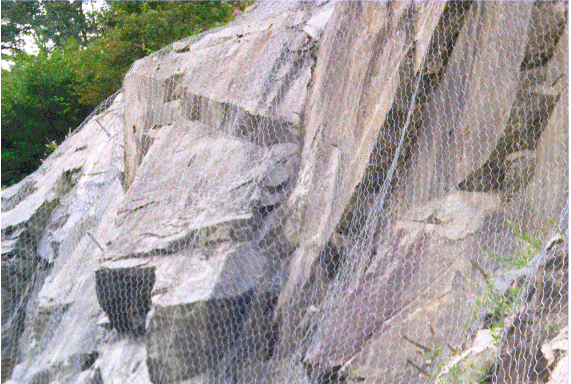
Chutes de pierres : protection par filets (grillage)
